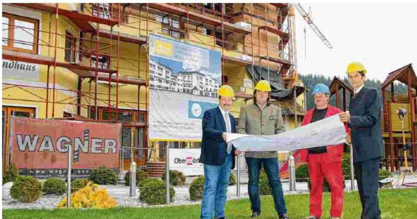
Hoteller Leopold Schöller, Bauleiter Hans Üblacker, Poller Gerhard Hahn und Versicherungsberater Gerhard Redl auf der Baustelle der Aumühle.
